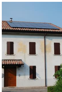
Impianto fotovoltaico 5,16 kWp Guastalla - RE
